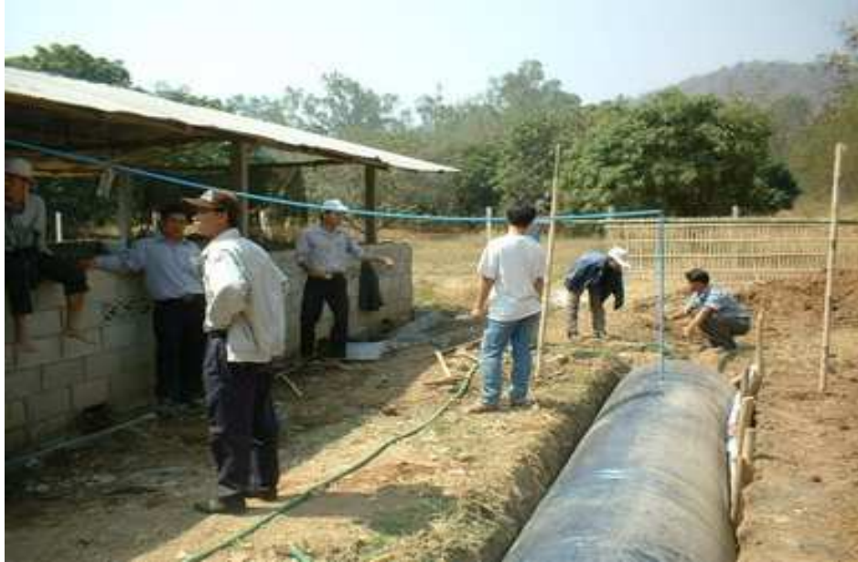
ติดตั้งท่อนำก๊าซจากถุกหมักไปยังขวระบายก๊าซ
